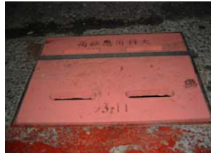
水 10 第五次檢查-正面 (11.30) 高性能水泥砂漿+玻璃纖維布溝蓋 (大)
