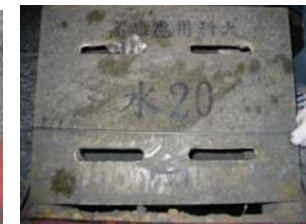
水 20 第五次檢查-正面 (11.30) 環氧樹脂砂漿+電木板溝蓋 (大)
