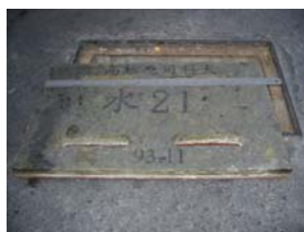
水 21 第五次檢查-正面 (11.30) 環氧樹脂砂漿+電木板溝蓋 (小)
