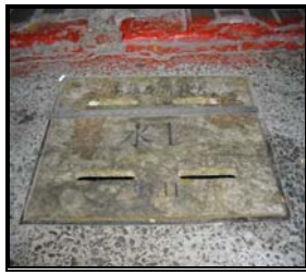
水 1 第五次檢查-正面 (11.30) 環氧樹脂砂漿溝蓋 (大)
