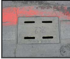
水 2 第五次檢查-正面 (11.30) 環氧樹脂砂漿溝蓋 (小)
