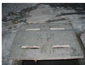
水 18 第五次檢查-正面 (11.30) 高性能水泥砂漿+電木板溝蓋 (大)
