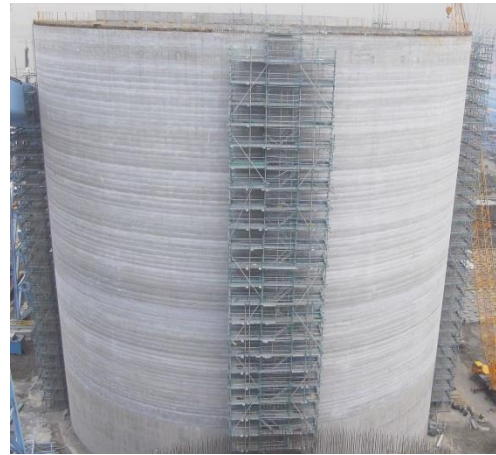
圖 3-21 施工架上下設備
