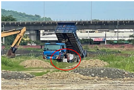
圖 10 門禁管制設置現況
